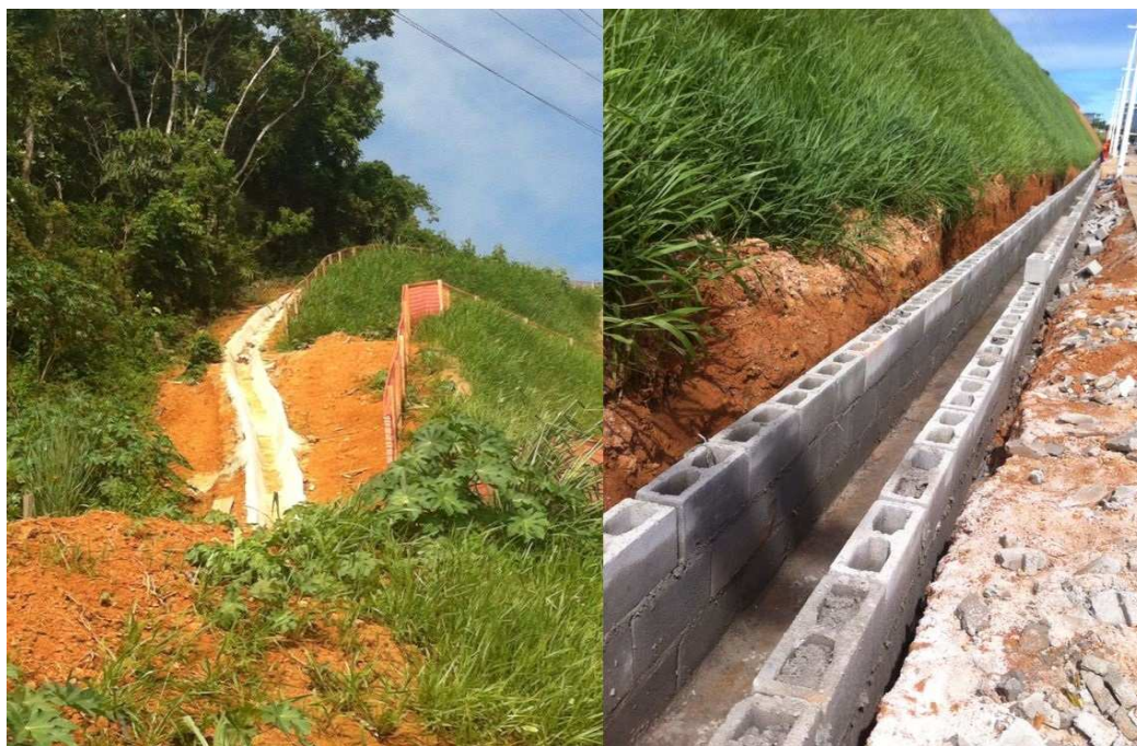
Figura 5 - Sistema de drenagem composto por escadas hidráulicas, bermas e canaletas Fonte: Grupo de Pesquisa - LAGEO 2014
