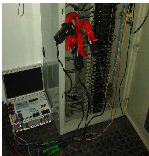
Figura 2 – Analisador de energia instalado
