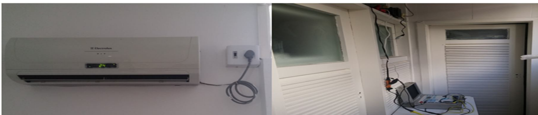
Figura 15 – Ar condicionado e analisador de Energia RE 2000
